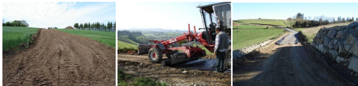
Illustration 10 : Tracé de la piste | Illustration 11 : Pose du géotextile | Illustration 12 : Mise en place du gravier
