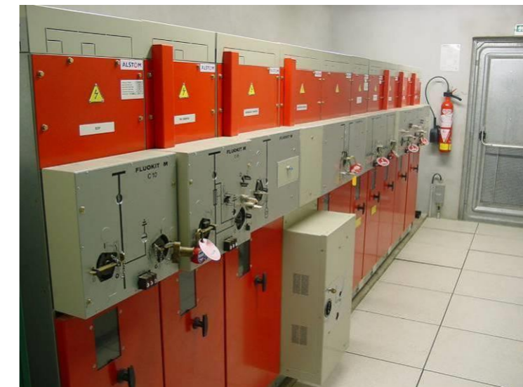
Illustration 5 : Intérieur d'un poste de livraison
